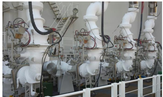
Fig. 1 Loading arms connected to an LNG tanker
